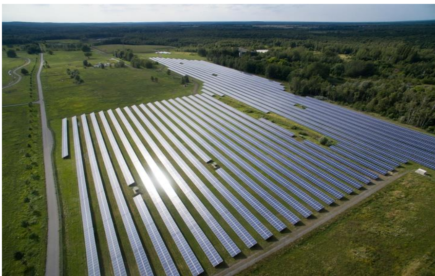
Příklad pozemní instalace - Zdroj: Fotolia.com - fotoak80
